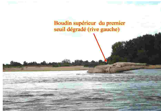
Vue de l'épi gauche du premier seuil dont le boudin supérieur se dégrade cinq années après sa réalisation (coût des deux seuils : 3 M d'euro)...
