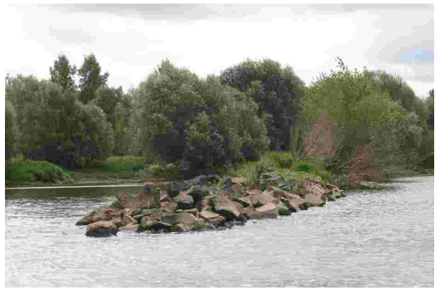
Epi dont l'extrémité a été consolidé par des enrochements de gros calibre particulièrement inesthétiques qui lui ont permis de résister au courant jusqu'à présent...
