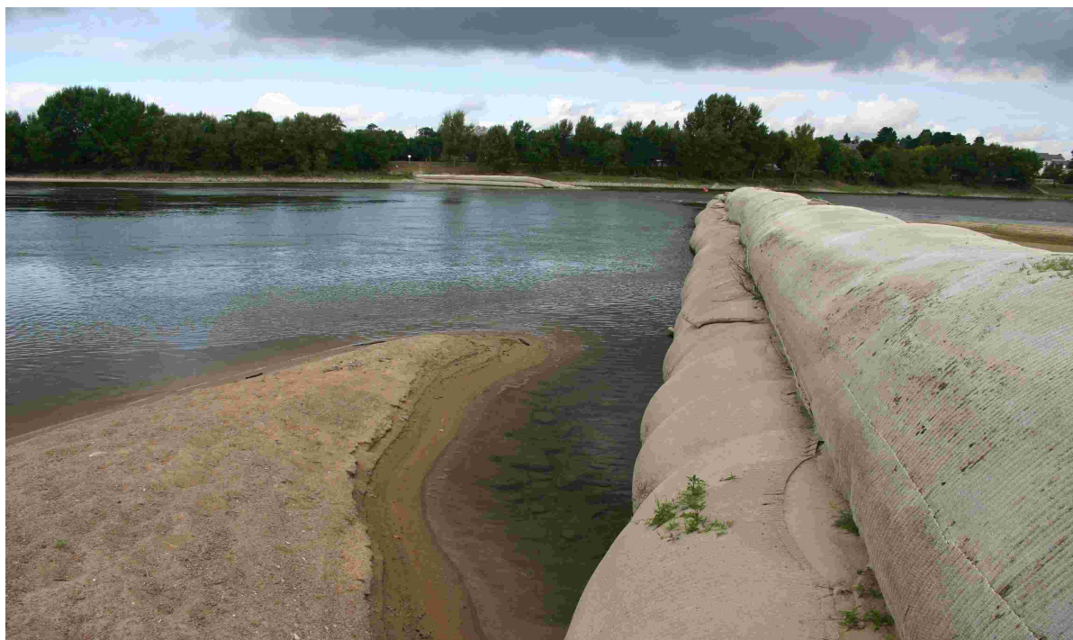
Ces épis sont vraiment à « radier » après avoir montré ce qu'il fallait éviter de faire... et pour rebondir sur un nouvel aménagement expérimental mieux intégré au patrimoine.
