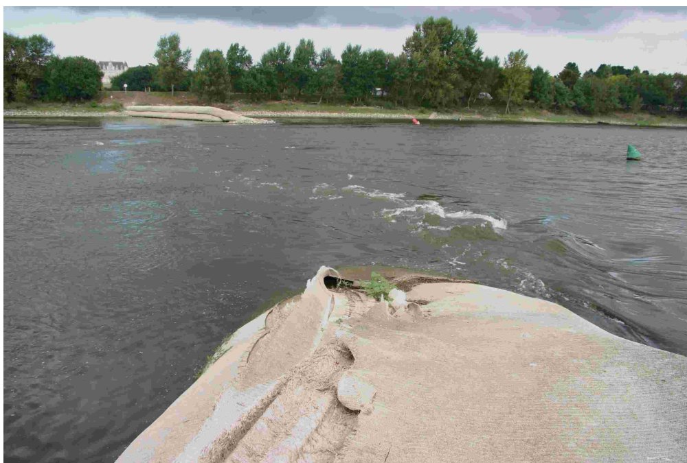
En 2008, vue de l'extrémité du premier épi, rive gauche : le géotextile du boudin supérieur s'est désagréé et le sable s'est vidé... Depuis, la dégradation s'est bien sûr poursuivie.
